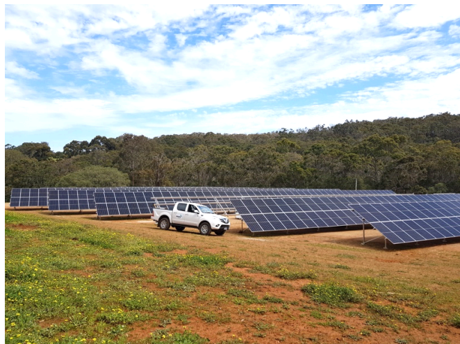
The 230kW Solar Array
