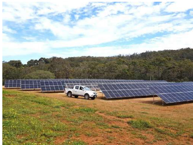
The 250kW / 600kWh BESS
